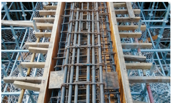
图12 埋件在混凝土振捣的过程中移位
