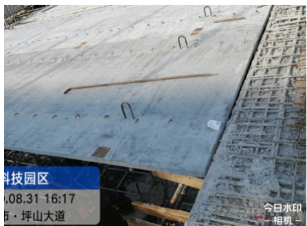
图11 第一次浇筑面过高
