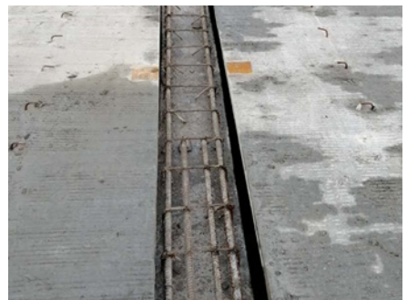
图13 双T板起拱与现浇梁缝隙过大
