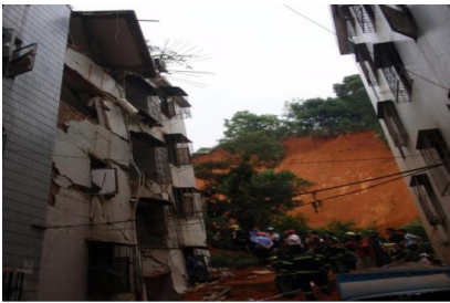
图3 长排村挡土墙倒塌（2004年8月31日）
